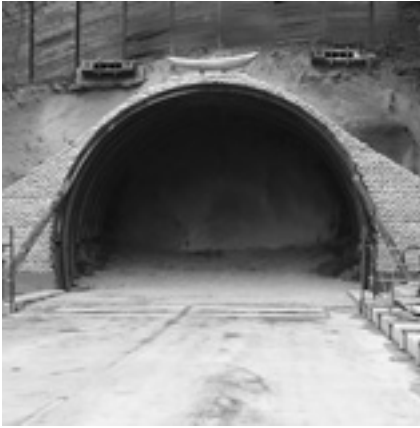
トンネル名：養瀬トンネル 施工者：若築建設・扇建設共同企業体 発注者：徳島県 施工：平成19年9月～平成20年5月 写真撮影日：2007年（平成19年）10月3日
