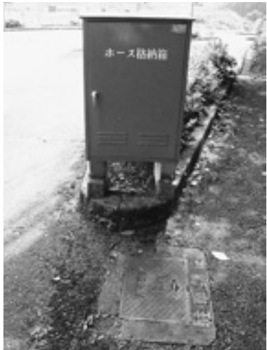
消火栓とホース収納箱（神領字東野間）
