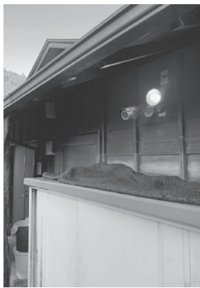
防災カメラ設置状況
