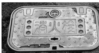
二本木地区の消火栓
