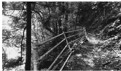
傾いたフェンス
