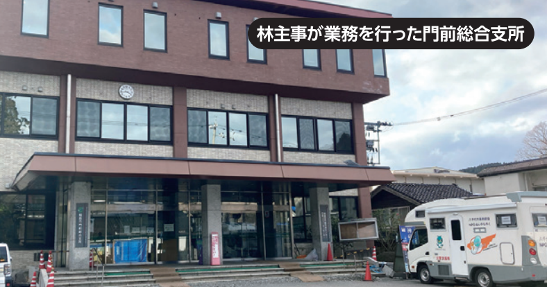
門前総合支所前の損傷箇所
