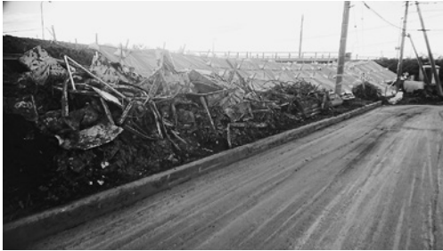
▲決壊した箇所
